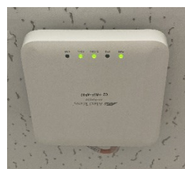
南多摩病院の無線 LAN ルーター
